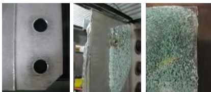
写真3 添接板すべり
